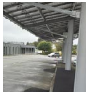
Ombrières photovoltaïques sur le parking du restaurant scolaire
